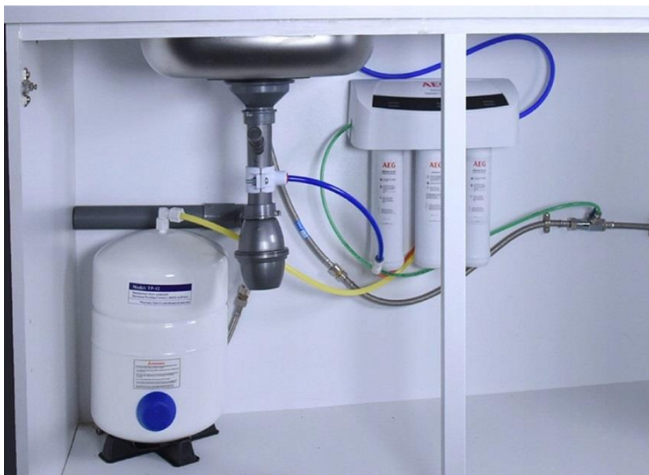
Altro dettaglio impianto depurazione
