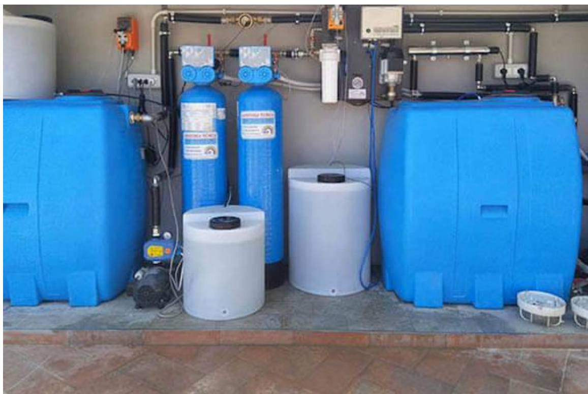
Impianto depurazione acqua potabile
